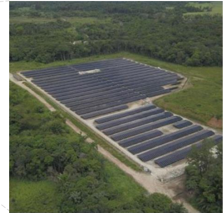
Parc solaire Savane des Pères (production intermittente + stockage)
